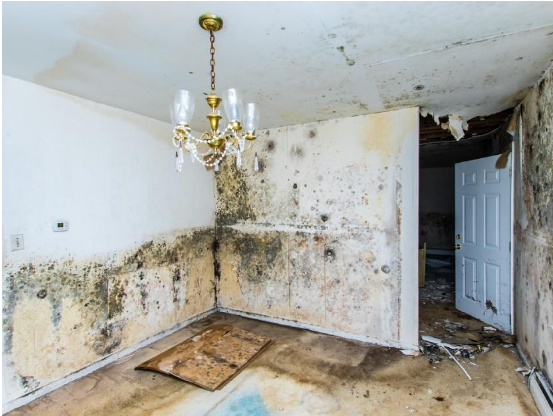
Figura 64 Moho Negro en interior de vivienda. (Souza, 2020)
